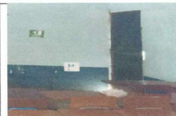
Foto 4: Puerta de aula se encuentra en mal estado no cuenta chapa.
