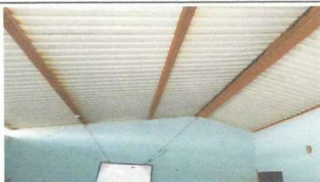
Foto 3: Estructura metálica de cubierta con alto grado de oxidación modulo I.
