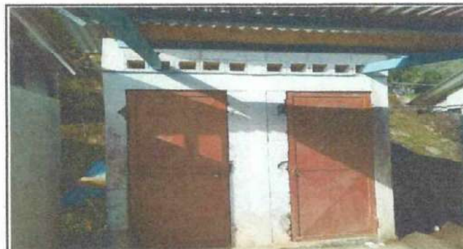
Foto 6: Letrina en mal estado.
