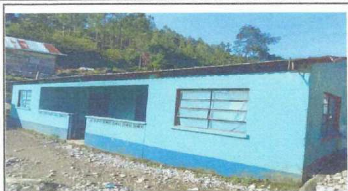
Foto 1: Vista panorámica de modulo I, paredes con humedad.
