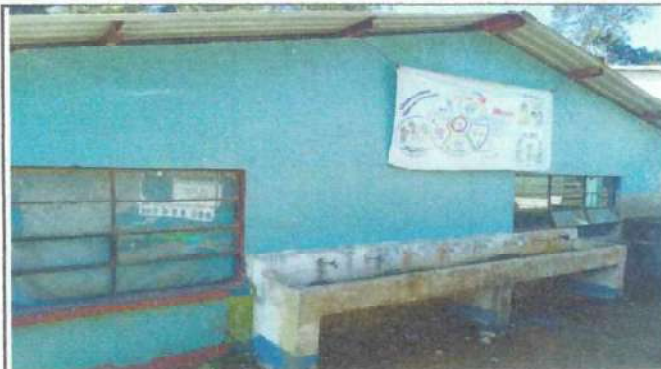
Foto 2: Vista posterior de modulo I, Ventanas con deterioro.
